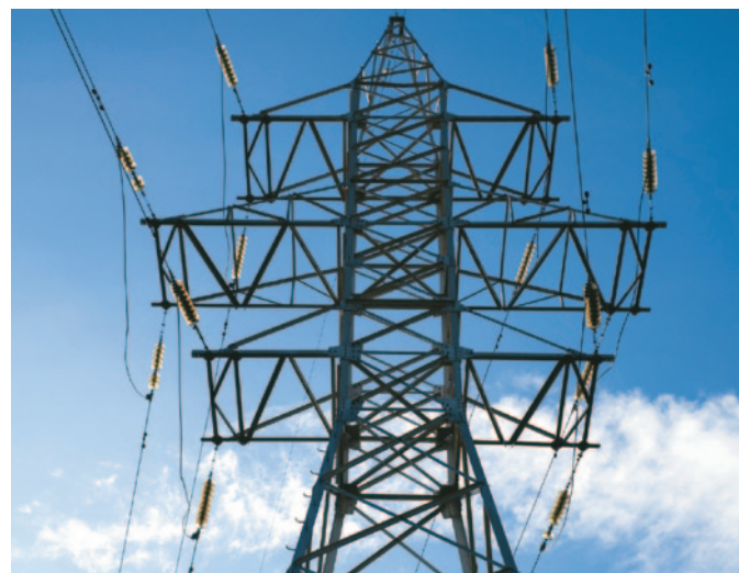
Alejarse de las líneas de alta tensión
