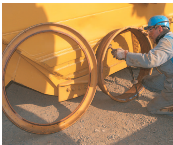
Limpiar y volver a pintar las partes oxidadas de los componentes metálicos
